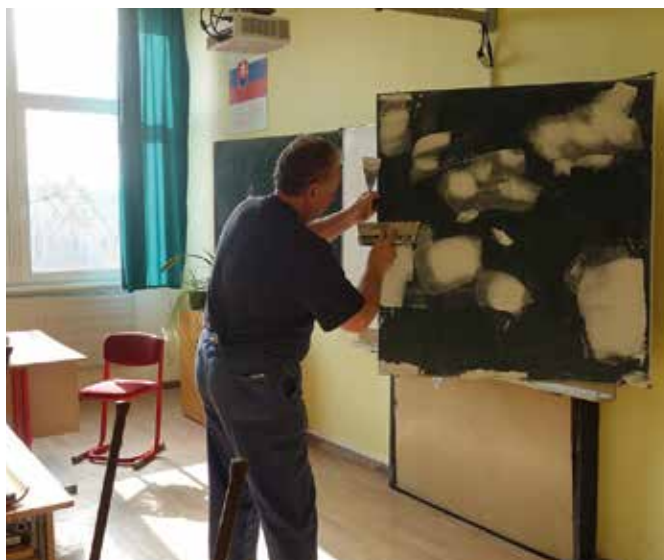
Felújították a táblákat
