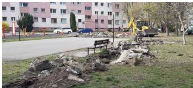
Folyamatban a Duna utca parkosítása, az Area munkatársai rengteg betont ástak ki és távolítottak el (Képarchívum)
