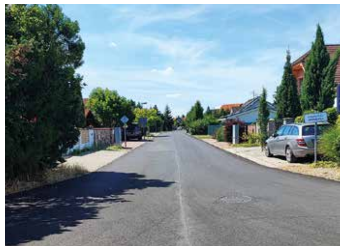
V uplynulých týždňoch pokračovala rekonštrukcia ulíc, bol obnovený povrch vozovky na Astrovej ulici a na Strednej ulici v Mliečne.
